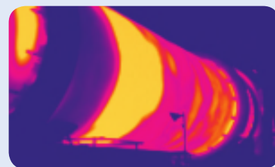
Rivestimento refrattario danneggiato
